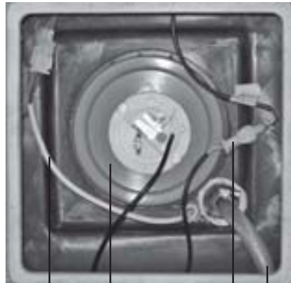
Couvercle d'inspection, réservoir d'eau
