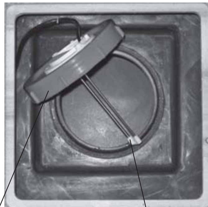
Couvercle d'inspection, réservoir des eaux usées Tiges de sondes du réservoir des eaux usées
