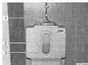
Fig. 198 Vase d'expansion pour le chauffage à eau chaude
