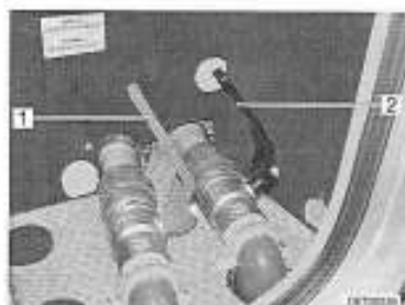
Fig. 174 Robinet de vidange dans le double plancher
